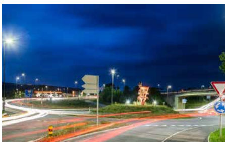
Straßenbeleuchtung: die EN 13201
